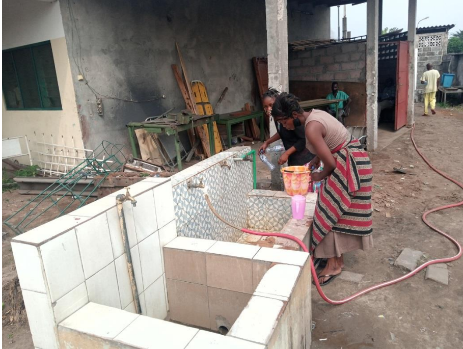
Photo 4 : Point d'approvisionnement d'eau à l'hôpital Saint-Joseph. (Source : NZALI Jean Trésor , 4 Mai 2020)
