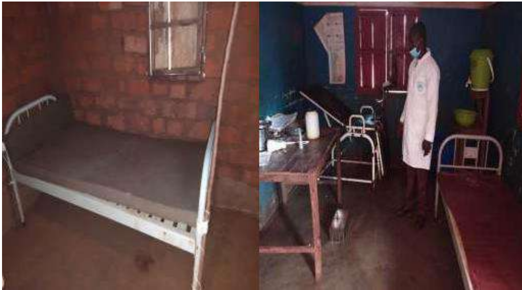
Photo n° 5 : Etat précaire de salle de soin à gauche Luambo à droite kalambambuji
