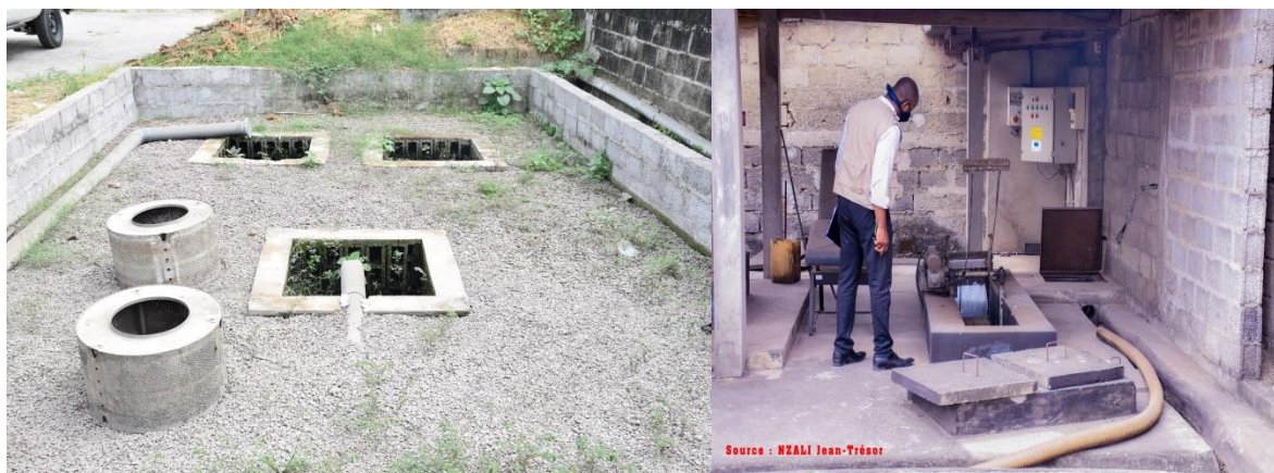
Photo 12 gauche et à droite : STEP de l'Hôpital de Monkole Source : NZALI Jean Trésor. Date : 7 Sept 2020
