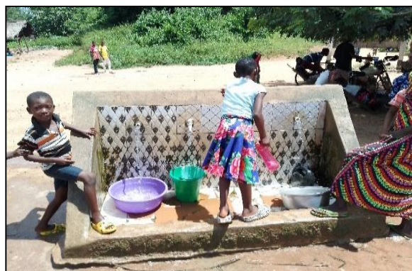
Figure 17: Borne fontaine avec un forage mécanique
