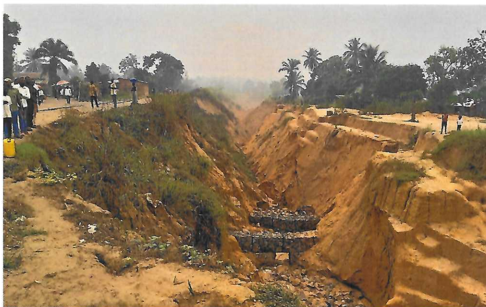
Figure 1. Voie ferrée de la SNCC menacée par l'érosion PK706_RN41 vers Tshikapa
